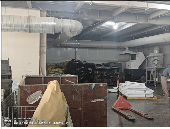
破碎机集气罩和收集管道
