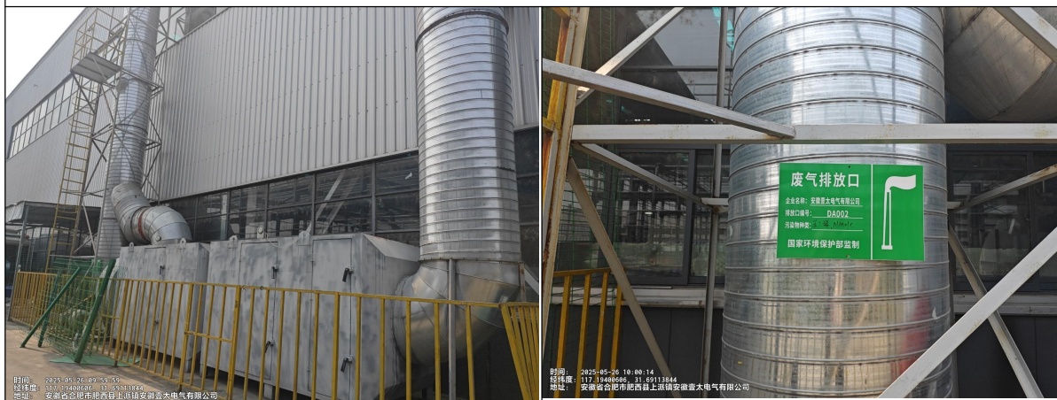
挤压成型，废气排气筒（DA002）
