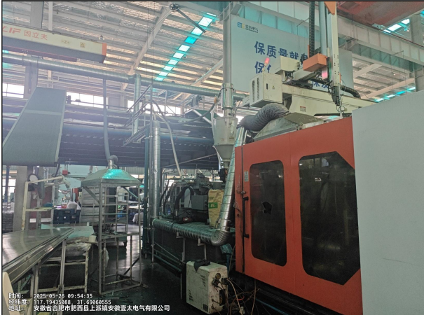
注塑机集气罩和收集管道
