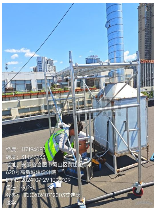
G12 DA002 污水处理 站废气排放口
