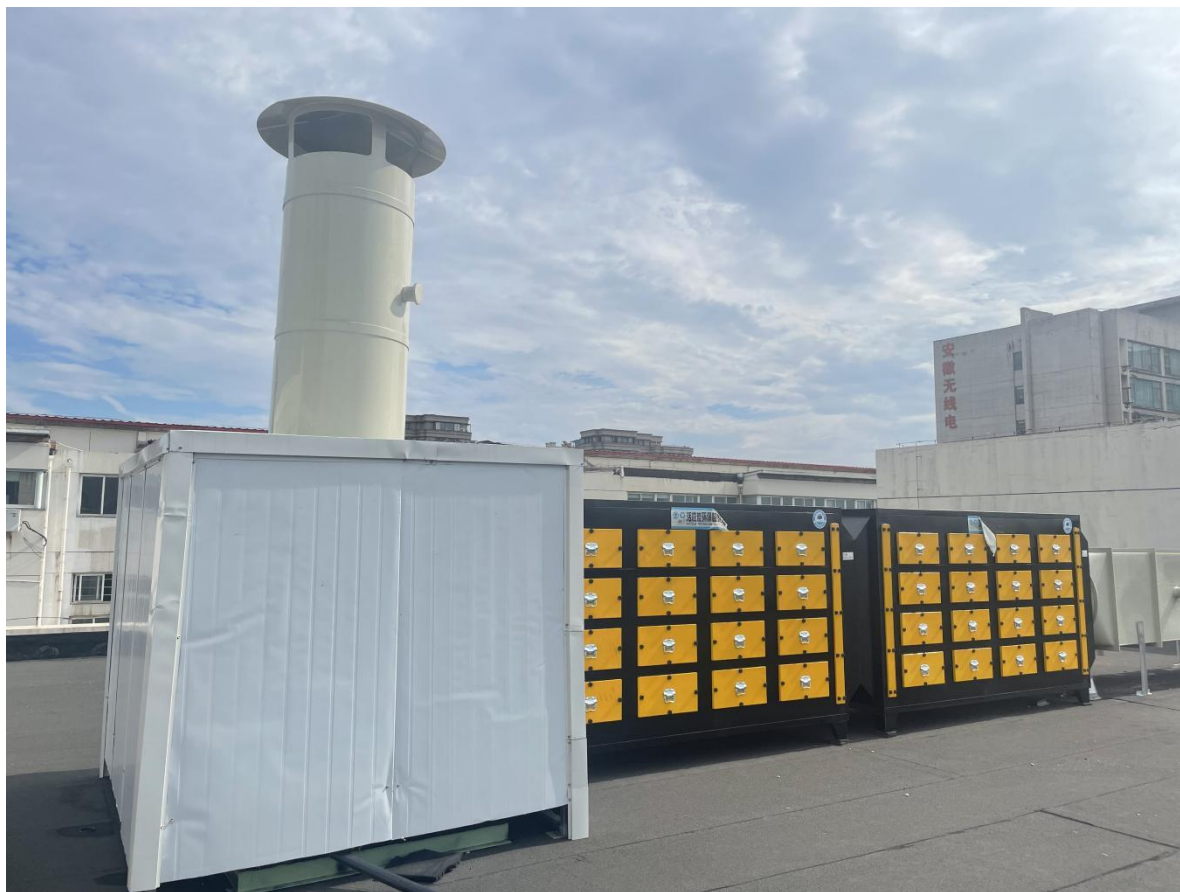
DA001 活性炭处理设施及排气筒
