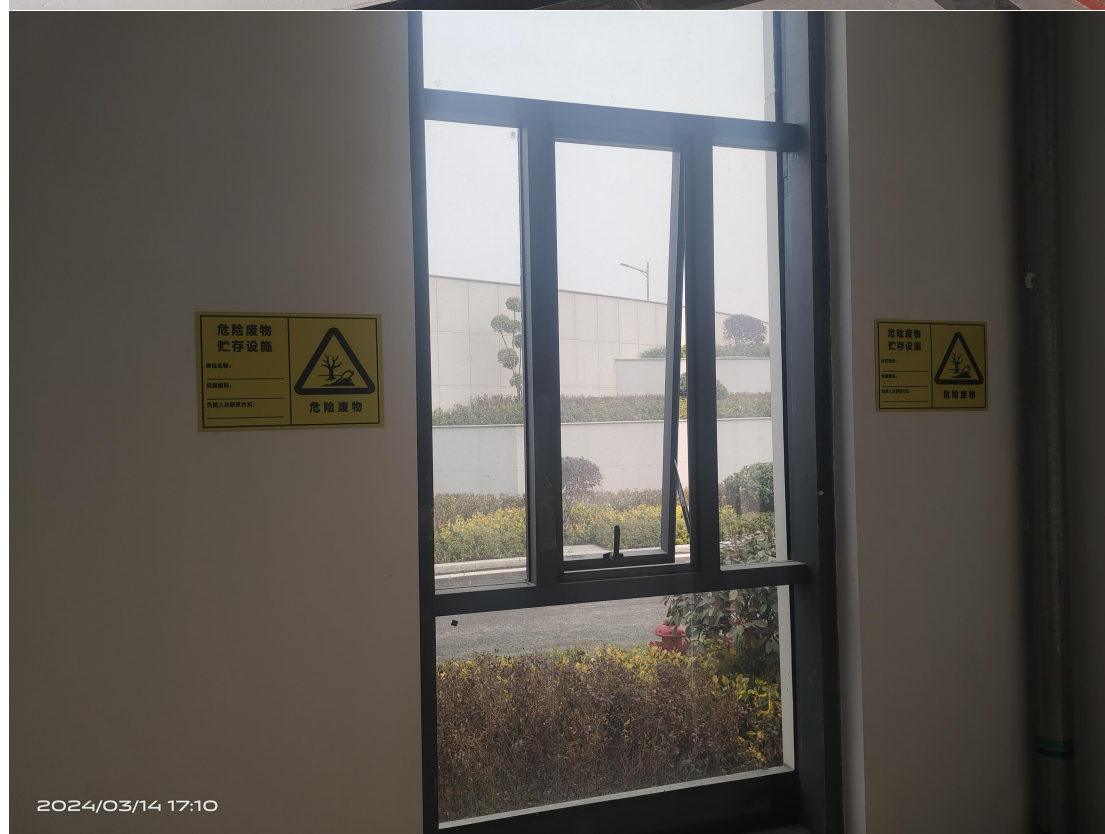
危险废物暂存间
