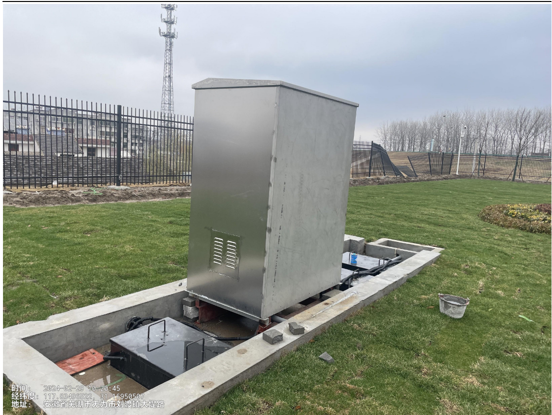
污水处理设施
