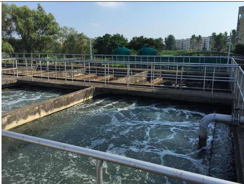
图 3-2 项目污水处理站
